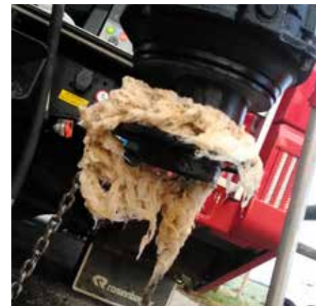
Feuchtes Toilettenpapier blockiert die Pumpwerke
