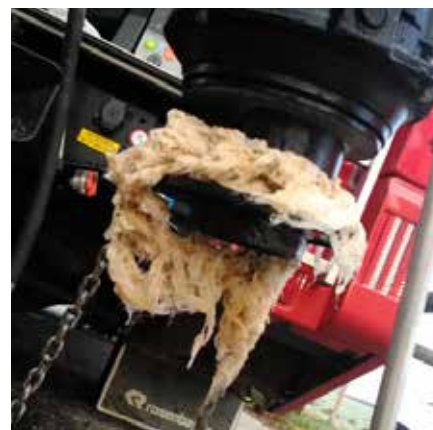
Durch einen Stoff beschädigte Pumpe beim Pumpwerk Hirschlag
